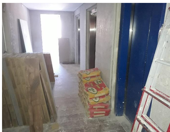
Frente elevadores subtelhado Bloco D
