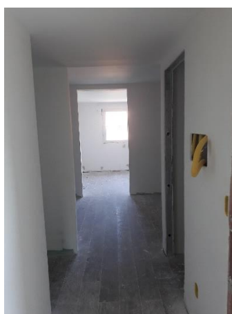
Apartamento subtelhado Bloco D
