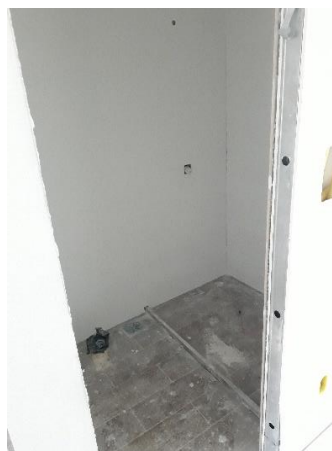
Banheiro subtelhado Bloco D
